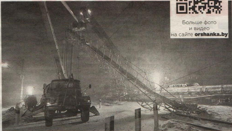
Участок теплотрассы упал на контактную сеть
